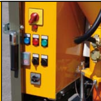
Cuadro eléctrico de comando Electric control panel
