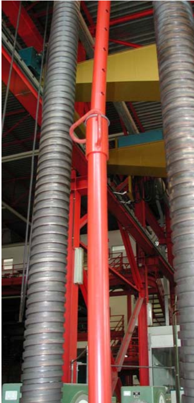
Foto 13, Inestabilidad del puntal.
