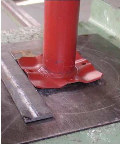
Foto 11, deformación permanente de la placa acanalada de base en correspondencia del colapso del gancho de apoyo y de la deformación de la perforación.
