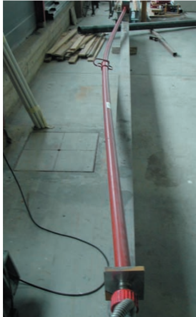
Foto 16, Inestabilidad del puntal.
