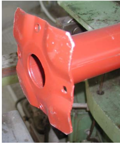
Foto 12, Deformación permanente de la placa acanalada.
