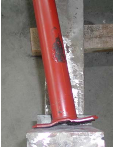
Foto 17, Rotación de la placa de apoyo a causa de la inestabilidad del puntal.
