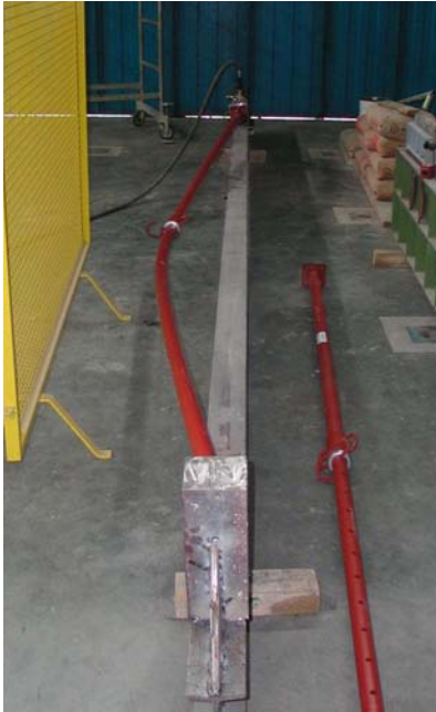
Foto 15, Inestabilidad del puntal.
