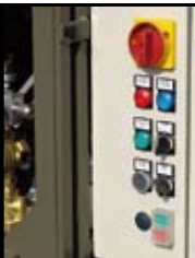
Cuadro eléctrico de mando
