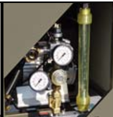
Circuito de agua con electrobomba
