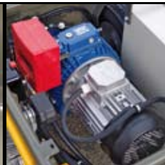
Motor eléctrico trifásico y variador de caudal
