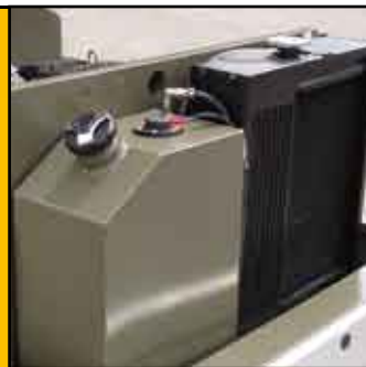
Tanque de gasoil y radiador
