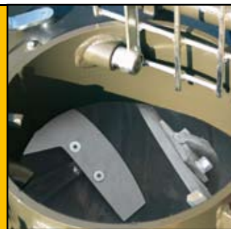
Entrada del tanque Vessel manhole
